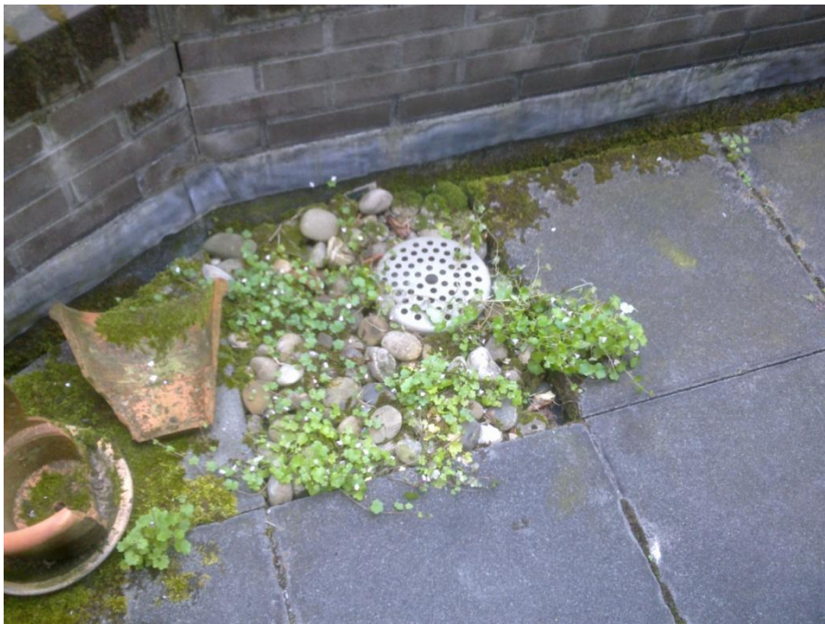
Foto 9: vervuilde randen rondom doorvoer. Waterstagnatie?
