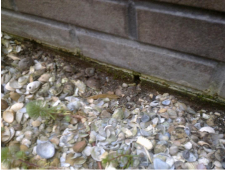
Foto 2: Kleischelpen en grond tegen gevel. De loodslab is niet meer zichtbaar.
