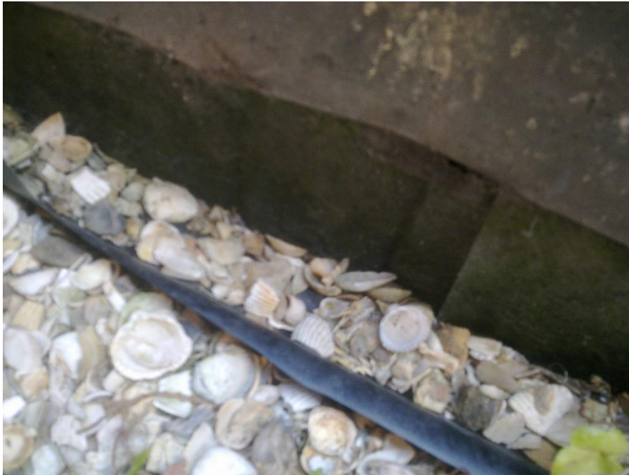
Foto 6: Achter het beschermende vlies zijn kleischelpen gekomen die de dakbedekking kunnen beschadigen.
